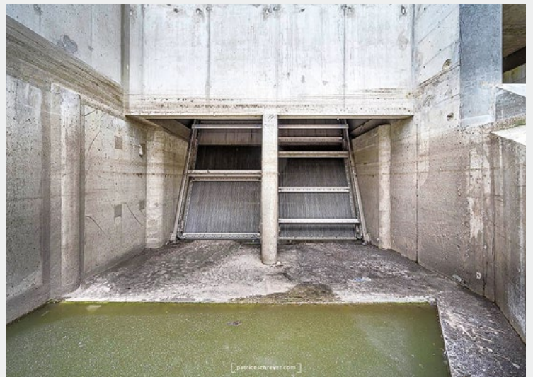
Fig. 1 Les dégrilleurs HUBER RakeMax haute capacité. Chaque dégrilleur permet de traiter un débit de 4,0 m 3 /s.
